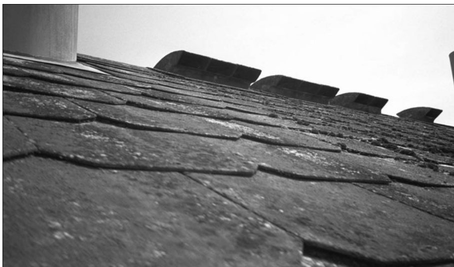
Figur 4. Fire aftrækshætter, eternit-ventilationsrygningssten, i forsøgsbygningens tagryg. Fra venstre ses to hætter som hver rummer tre aftrækskanaler, én hætte som rummer to aftrækskanaler og én hætte som rummer én aftrækskanal.
